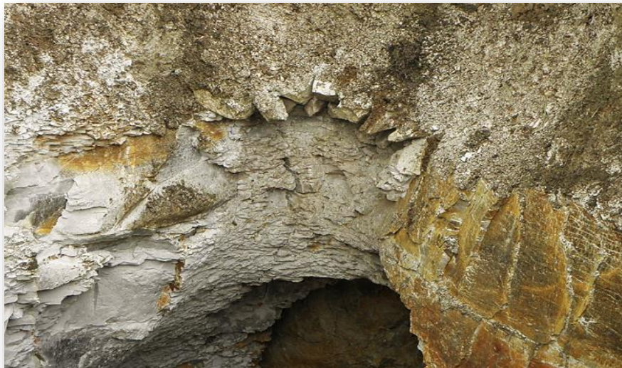
Effondrement au contact de l'encorbellement et du fantôme de roche
