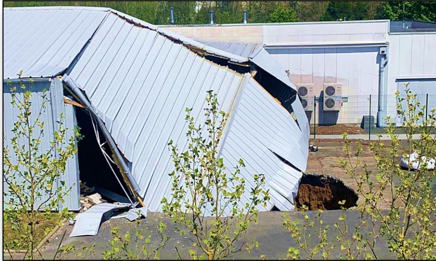
Exemple de ruine de catiche entraînant l'effondrement du bâti en surface.
